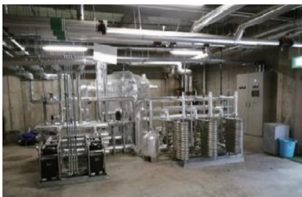
省エネを実現したゆと森倶楽部の廃熱システム
